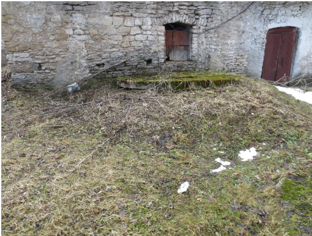
Joonis 5-30 Triigi pargi pk pumppla paikneb maa-aluses šahtis
