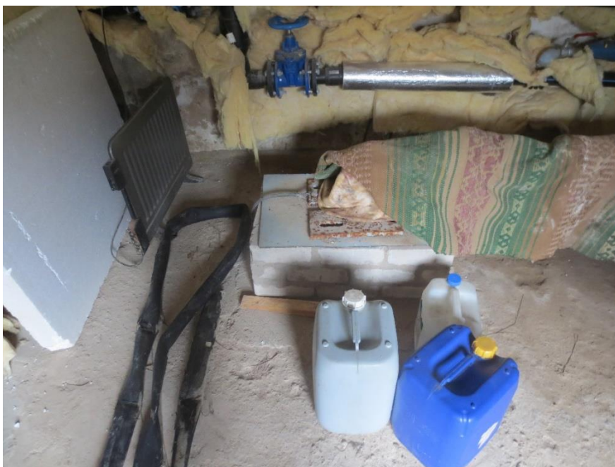
Joonis 5-2 EPT puurkaevpumpla sisevaade, puurkaevu päis, ajutine soojustus ja elektriradiaator
