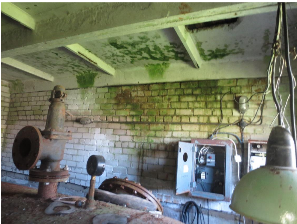
Joonis 5-22 Lasteaia pumpla sisevaade
