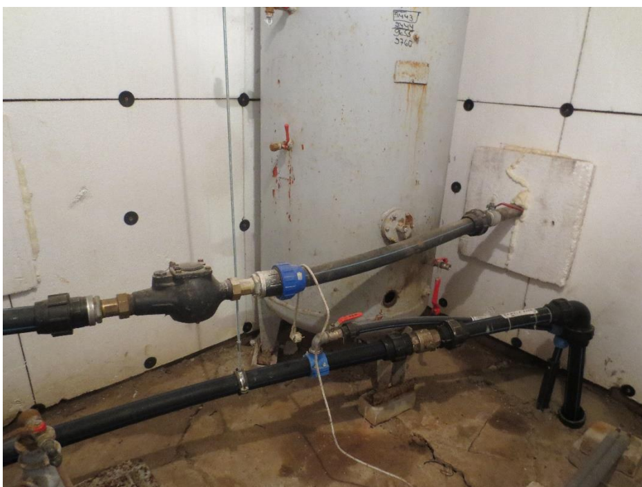
Joonis 5-10 Piirituse pumplahoone sisevaade. Torude hargnemised kolme eri veevõrku ja käigust väljas olev 2 m 3 -ne hüdrofoor
