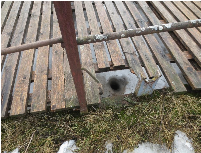
Joonis 6-22 Kilti mõisa ehk Liivaküla endise reoveepuhasti reovee „vastuvõtusõlm“
