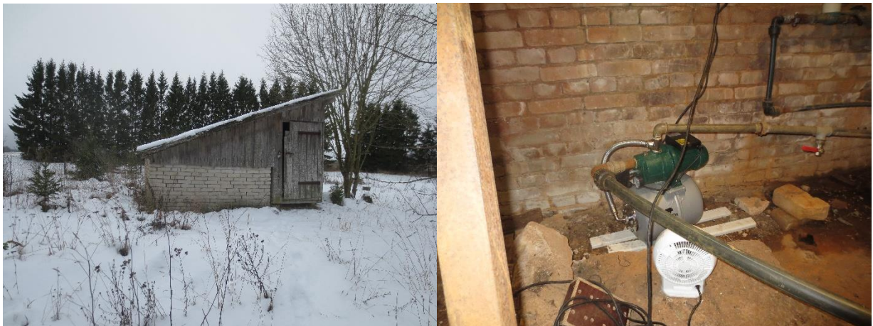
Joonis 5-48 Piibe puurkaevpumpla hoone välisilme ja sisevaade šahti (maapealne lokaalse automaatikaga pump)
