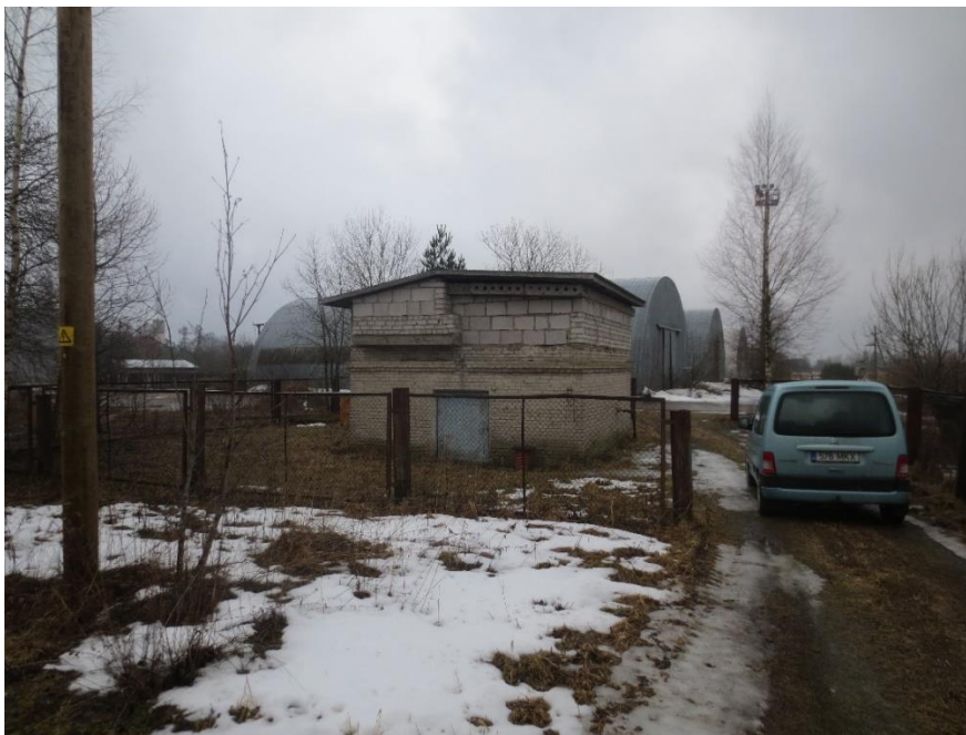
Joonis 5-1 Väike-Maarja EPT puurkaevpumpla nr 3564 välisvaade
