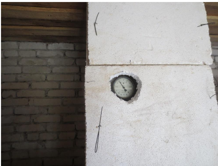
Joonis 5-28 Pumpla sisevaade, manomeeter on peidetud soojustusse
