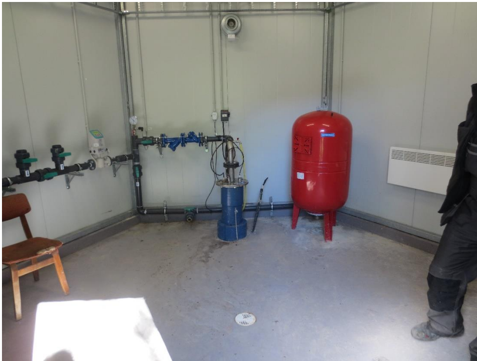
Joonis 5-18 Tähe puurkaevpumpa sisevaade (puurkaevu päis ja hüdrofoor, vasakul on näha toru hargnemised ja sulgeseadmed veetöötlusseadmete paigaldamiseks)
