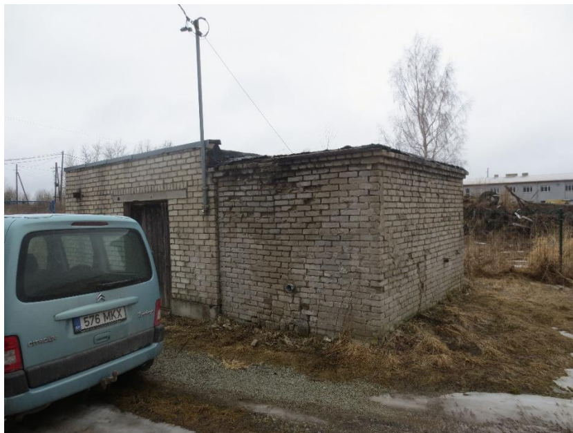
Joonis 5-8 Ebavere Piirituse puurkaevpumpla välisvaade. Hoonel näha lagunemise märke, näha on ka otseväljaviigu ava
