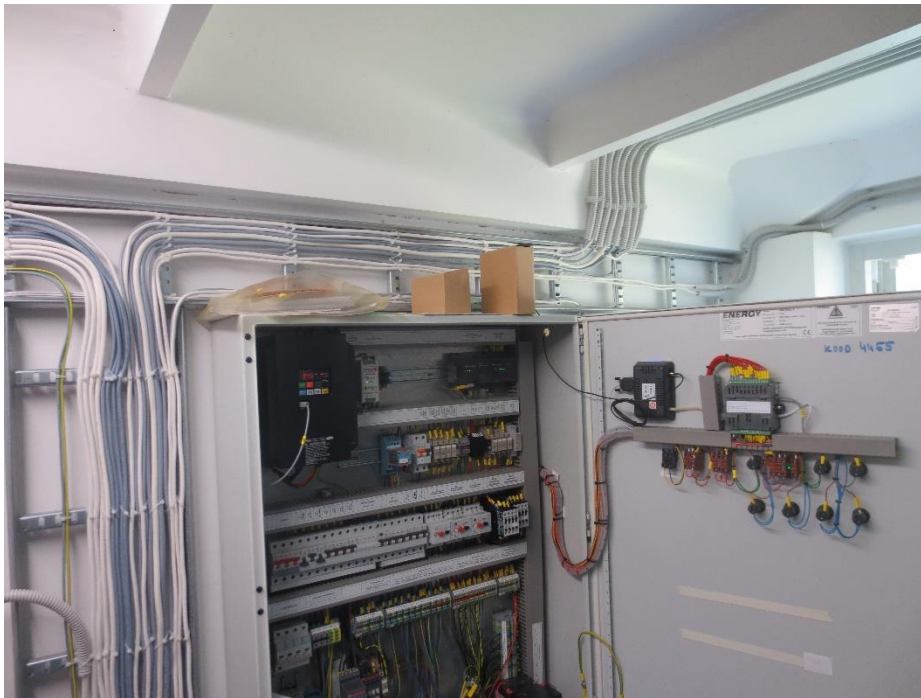
Joonis 5-16 Linnamäe pumpla elektri-automaatikablokk
