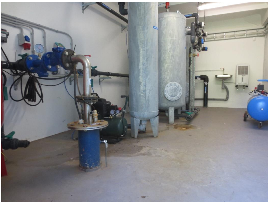
Joonis 5-15 Linnamäe pumpla sisevaade (puurkaevu päis, aeratsioonimahuti, filtrid ja kompressor)
