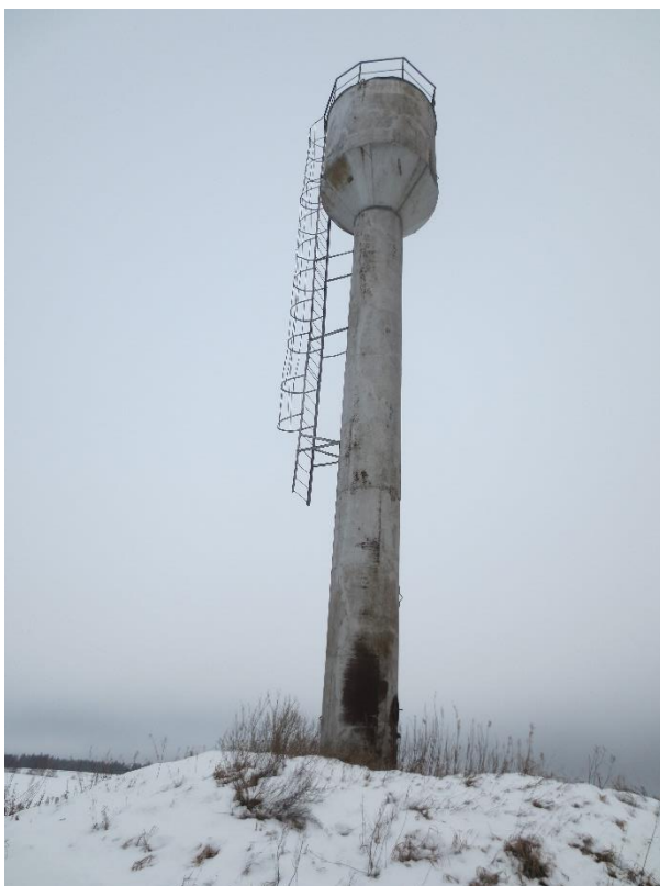
Joonis 5-46 Lammasküla puurkaevpumpla veetorn
