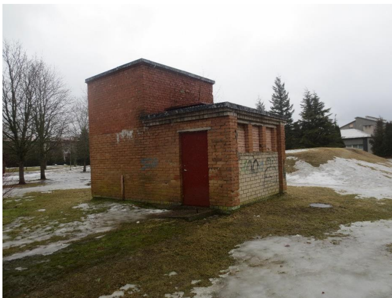
Joonis 5-6 Haigla puurkaevpumpla välisvaade, kõrgem osa mahutab püstiasendis 5 m 3 hüdrofoori. Hoonetaguses muldkehas asuvad vanad kunagised puhtaveereservuaarid
