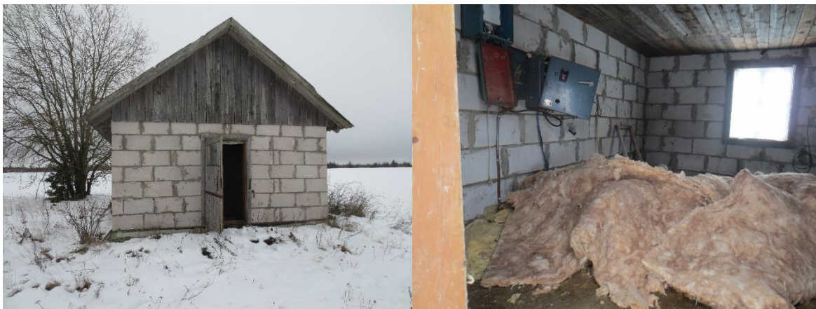
Joonis 5-45 Lammasküla puurkaevpumpla välis- ja sisevaade
