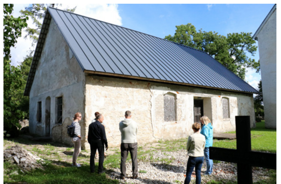
2010. a äikesetormiga kukkus kiriku tornikiiver kabeli katusele. 2016. a saadi uus katus peale, kuid ülejäänud tööd ootavad järgi. Foto Kristel Kitsing
